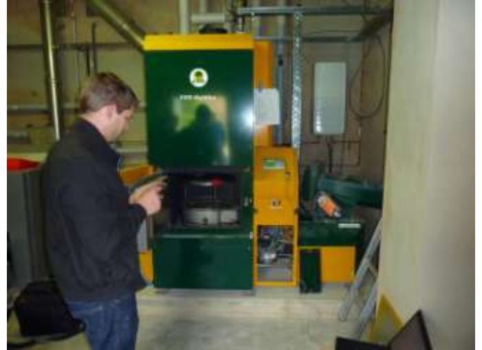
Mise en service par le technicien de KWB de la chaudière bois
